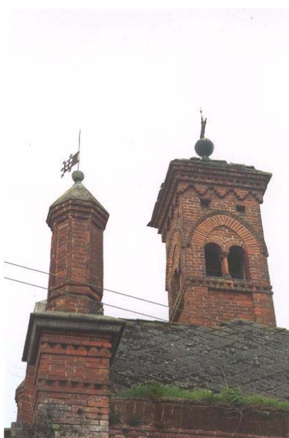
Negativo fotografico n° 20- Pennacchio e campanile
